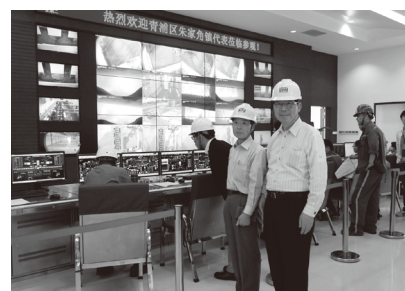
総合制御監視室
