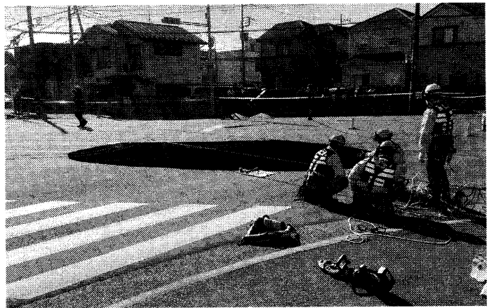
1月28日、埼玉県八潮市の県道に直径約10mの穴が突然開き、そこにトラックが転落。下水管の老朽化が原因だといふ
