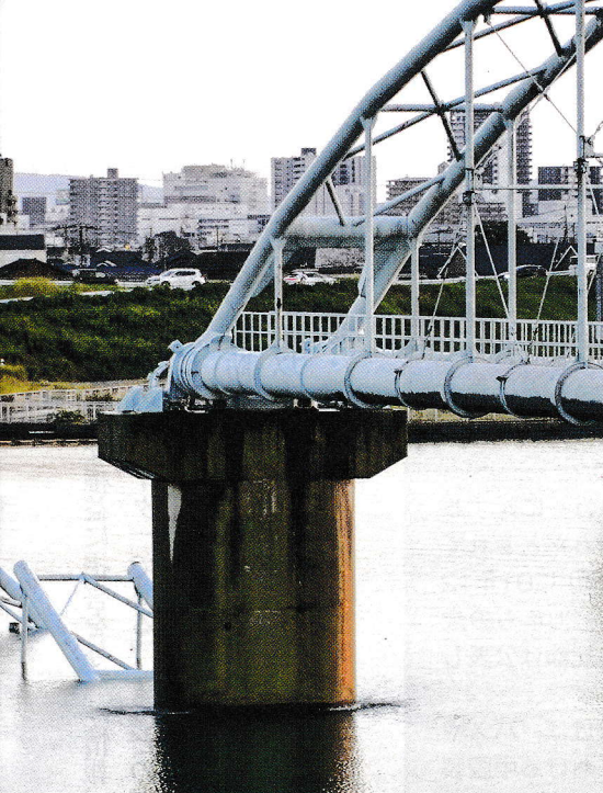
紀の川に架かる崩落した上水道用の橋の配管
